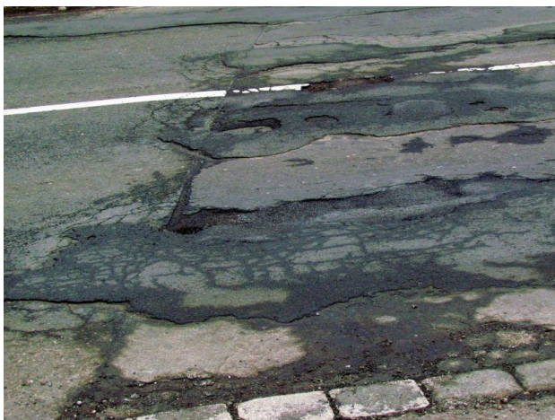
Frostschäden auf der Landwehrstraße in Höhe des Globus-Baumarkts
