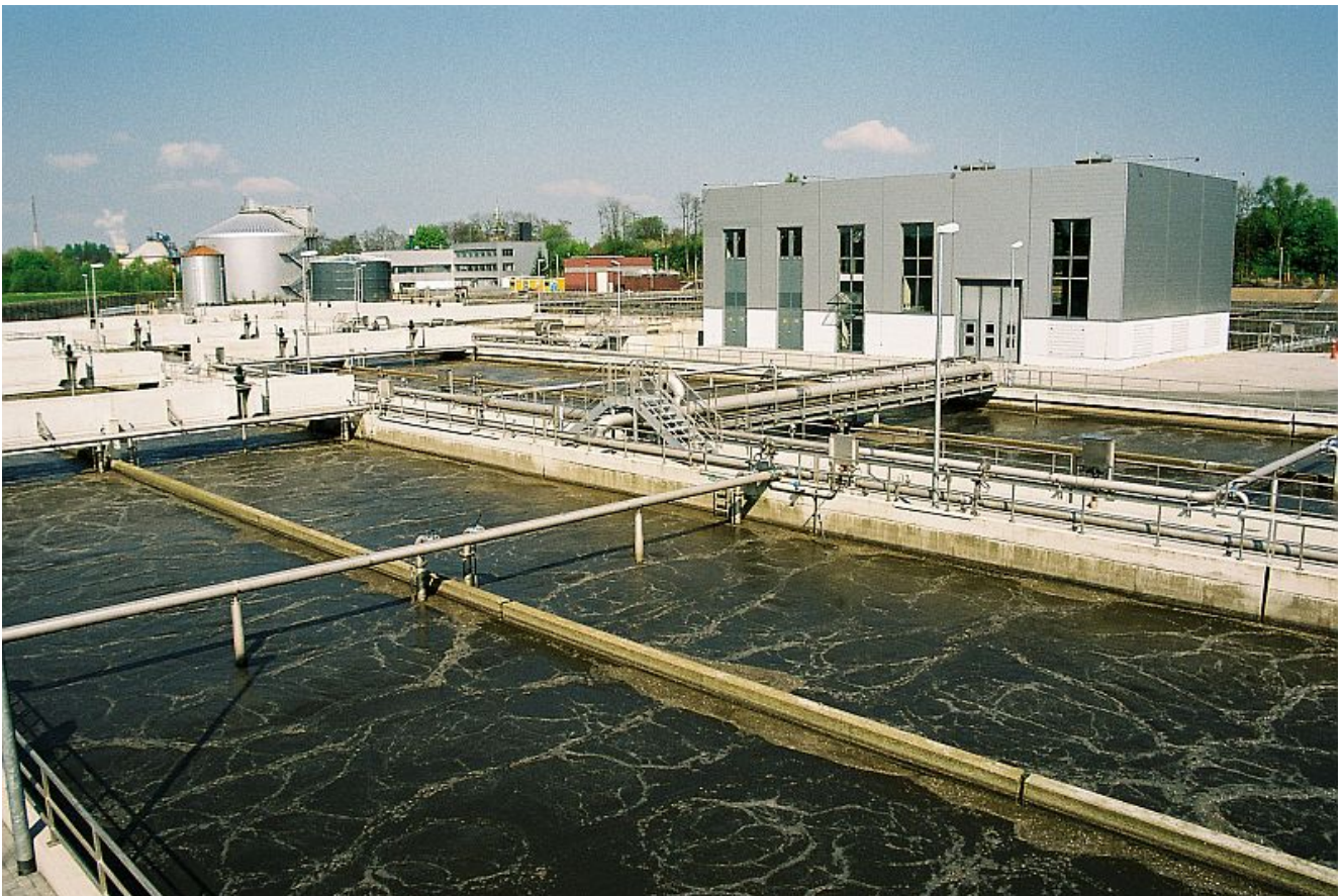
Kläranlage Lünen. Foto: Lippeverband
