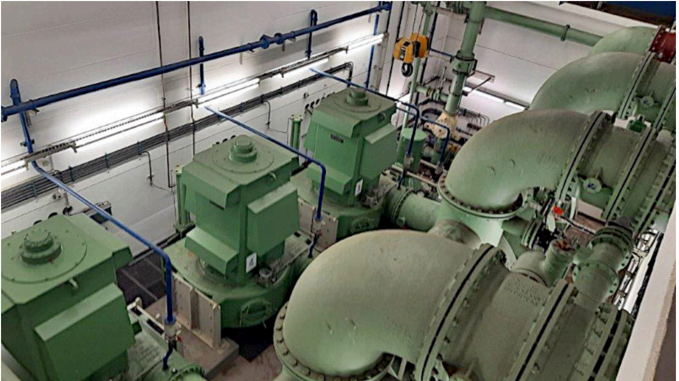
Pumpwerk Beverbach in Rünthe. Foto: Aktionskreis / Röcher
