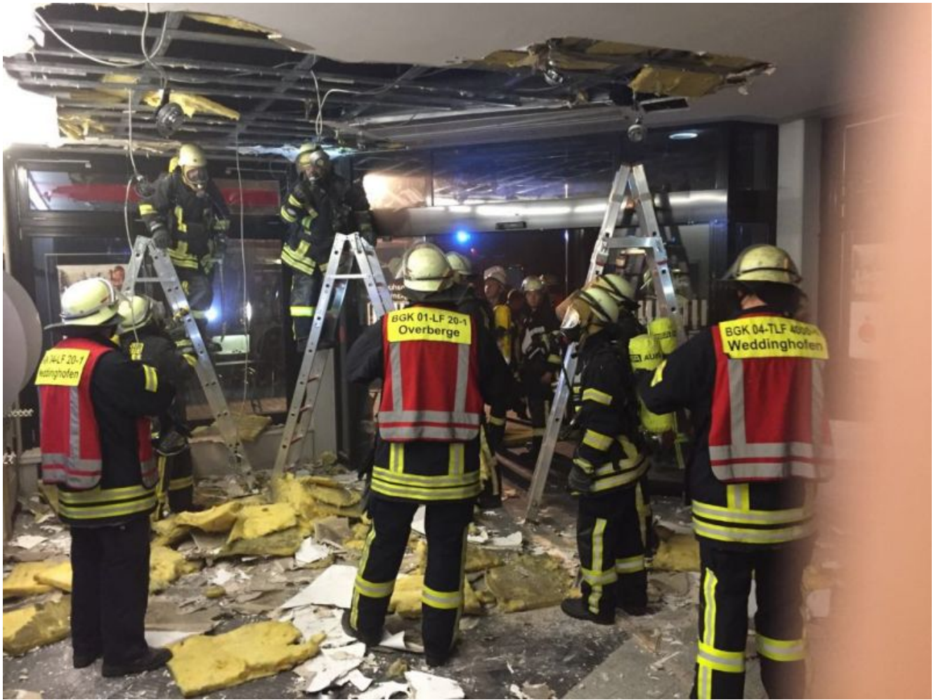
Ein Kabelbrand in der Decke über dem SB-Bereich war der Grund für den Feuerwehreinsatz in der Sparkasse Overberge. Fotos: Feuerwehr Bergkamen
