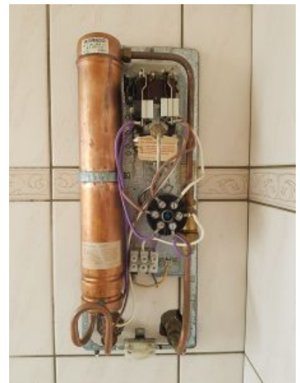
Der defekte Durchlauferhitzer.
