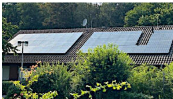
Das erste LiSe-Projekt. PV-Anlage auf dem Dach des ehemaligen Vereinsheims des Tennisvereins Blau-Weiß Bergkamen.
