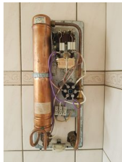
Der defekte Durchlauferhitzer.
