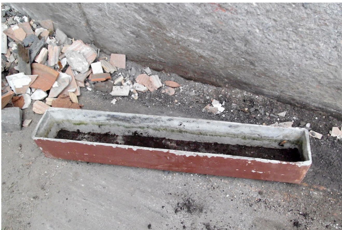
Asbest. Foto: GWA
