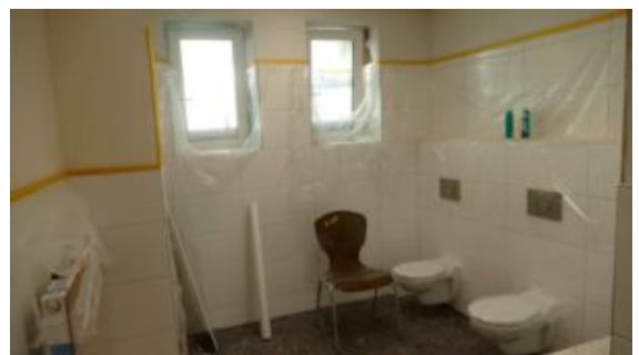
Die Toiletten für die OGS der Preinschule sollen auch
