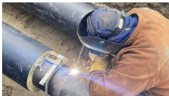
Die GSW wollen ihr Wärme- Netz sukzessive ausbauen. Foto: GSW
