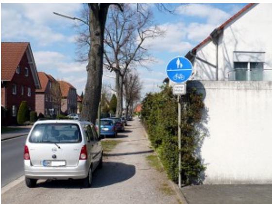
Der Schotter auf dem Gehweg
