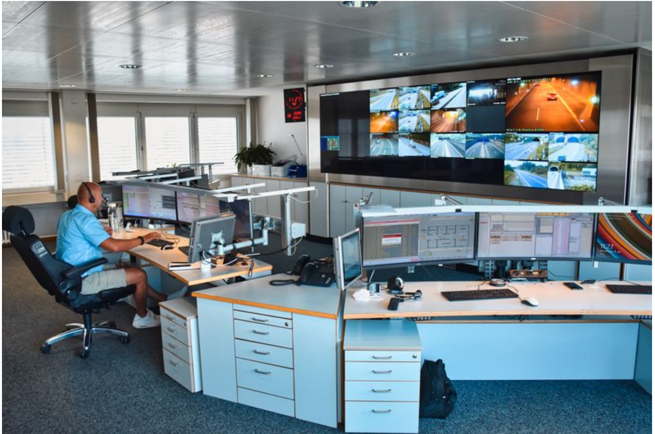
Operator Matthias Willms in der Tunnelleitzentrale. Foto: Autobahn Westfalen.
