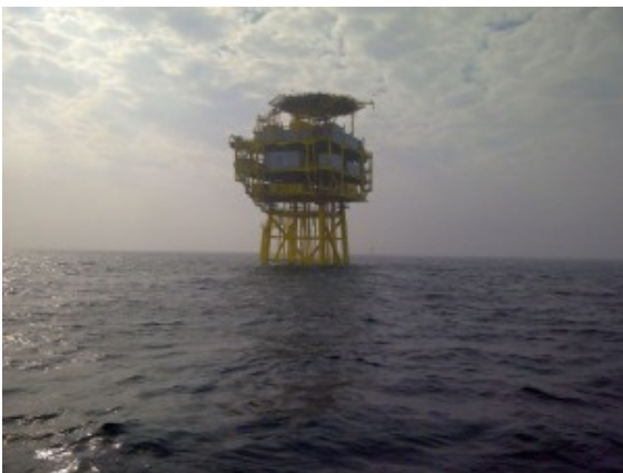
Die Umspannplattform in der Nordsee vor Borkum.
