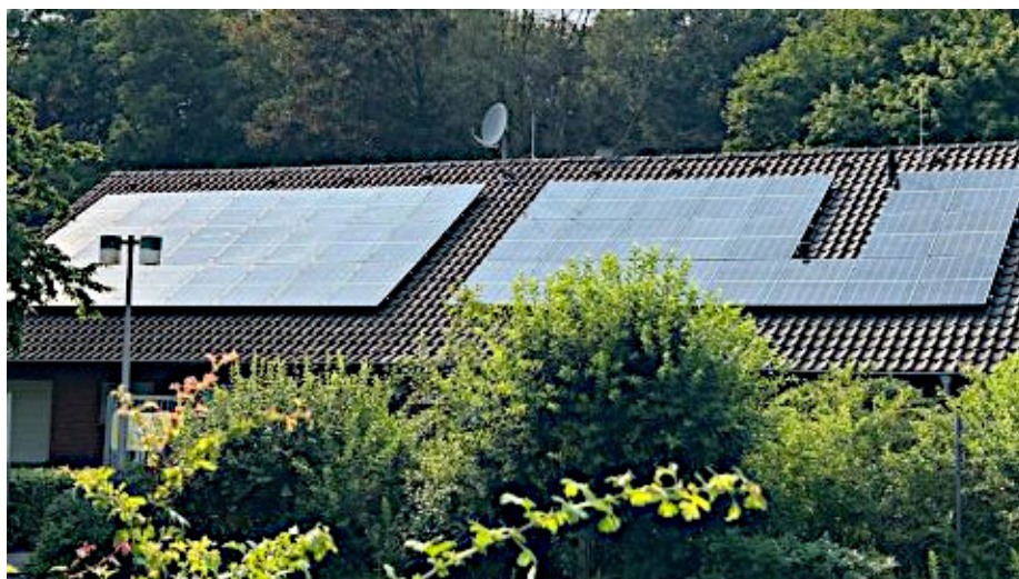
PV-Anlage auf dem Dach des Vereinsheims des Tennisvereins Blau-Weiß Bergkamen.
