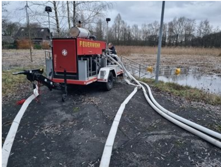
Hochwassereinsatz an der Overberger Straße. Foto: Feuerwehr
