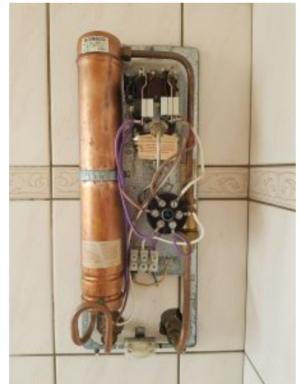
Der defekte Durchlauferhitzer.
