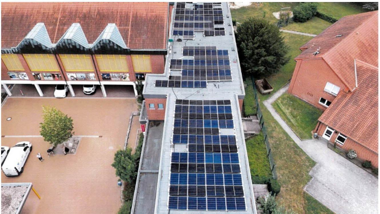
PV-Anlage auf dem Dach des Pestalozzi-Hauses.
