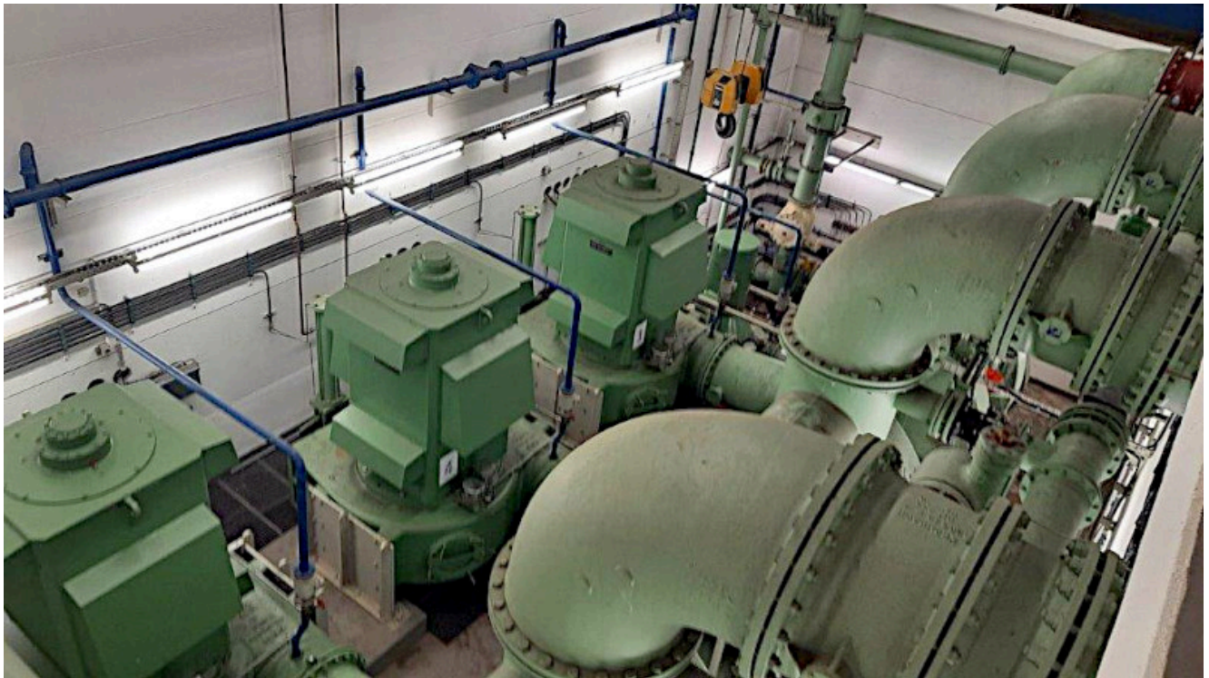
Pumpwerk Beverbach in Rünthe. Foto: Aktionskreis / Röcher
