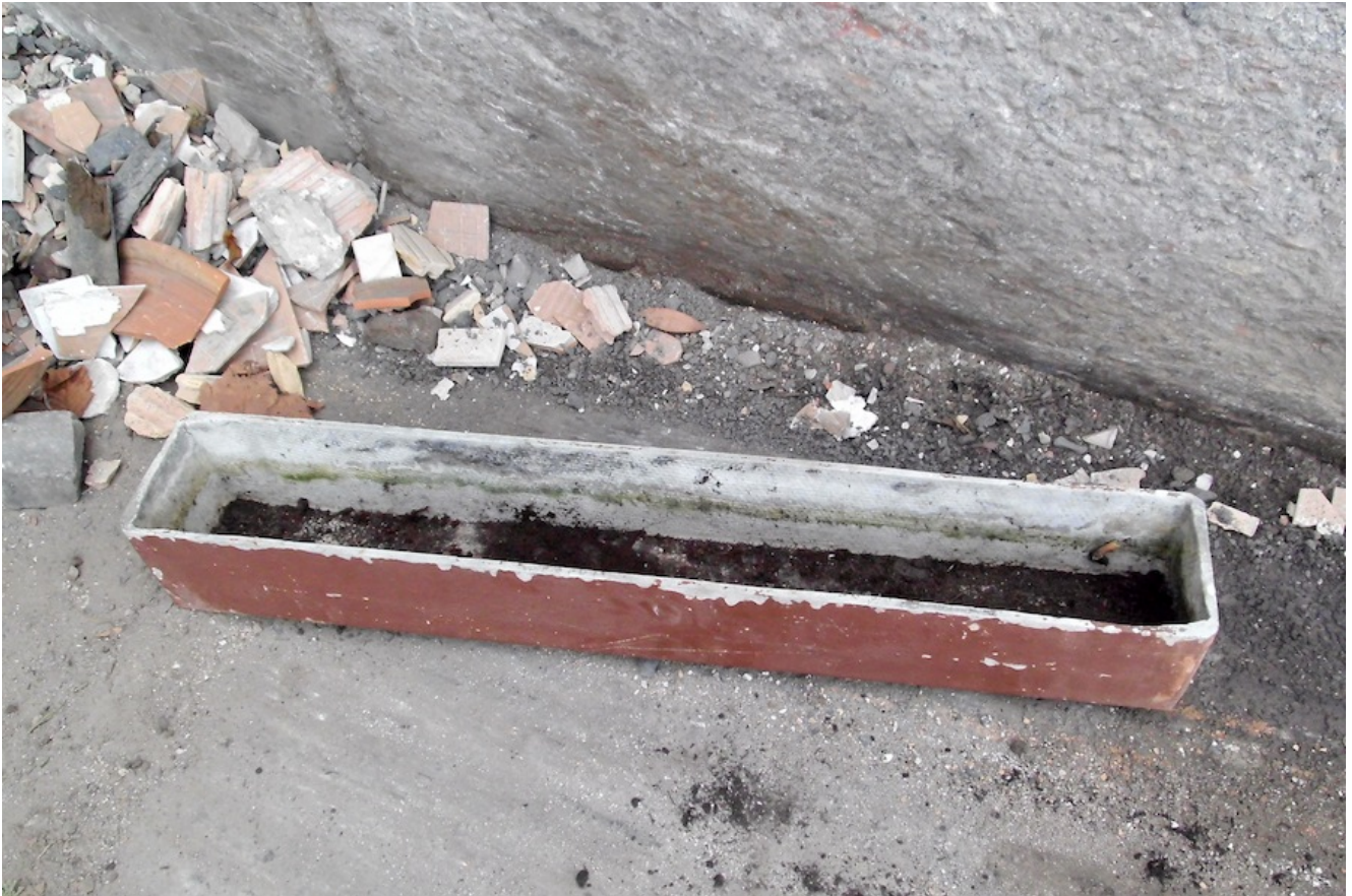
Asbest. Foto: GWA
