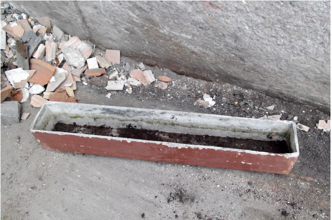
Asbest. Foto: GWA
